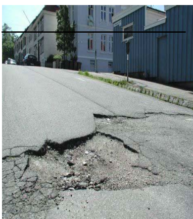
Senskader etter graving påfører vegholder store kostnader.
