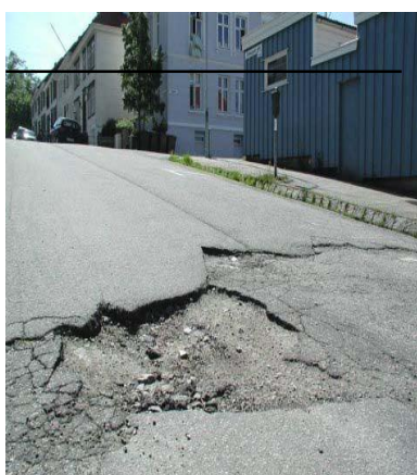
Senskader etter graving påfører vegholder store kostnader.
